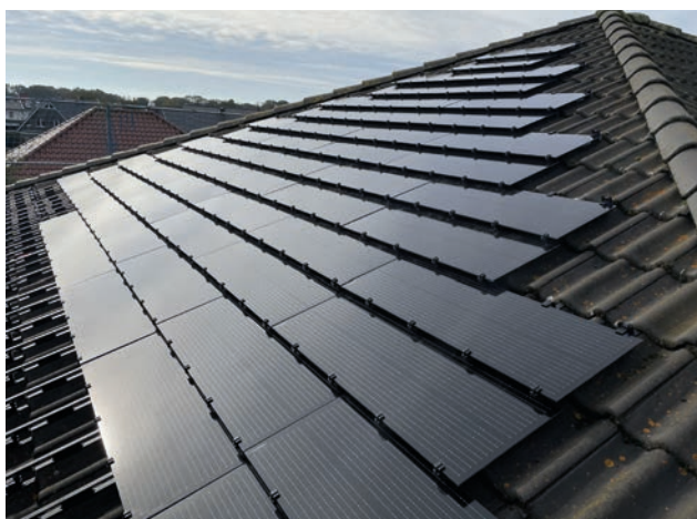
Le système SOLo sur le toit
